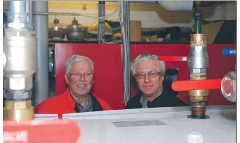
Gunnar Kjellberg och Kjell Kahn vid den nya bergvärmearläggningen som snart tas i drift.
